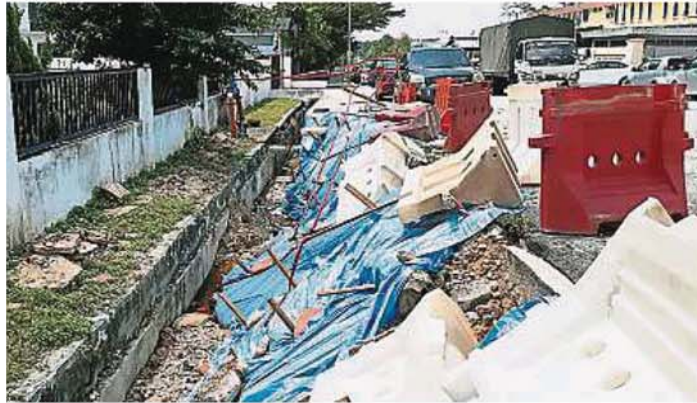
连日大雨的影响，行人道也崩塌。
