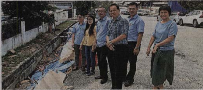
■王诗棋（左二）在黄启富（右起）、郑益清、李忠发及神建华，丘钦瀚（左）陪同下视察人行道崩塌处，并表示维修工程会在下个月进行。
